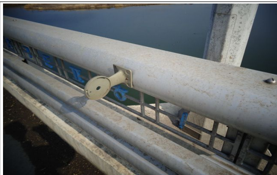
S23 텔리네이터 파손 (양평방향)
