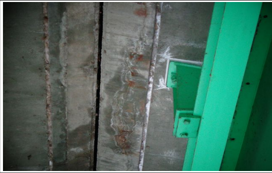
S8 폭 0.3mm미만 균열 (원주방향)
