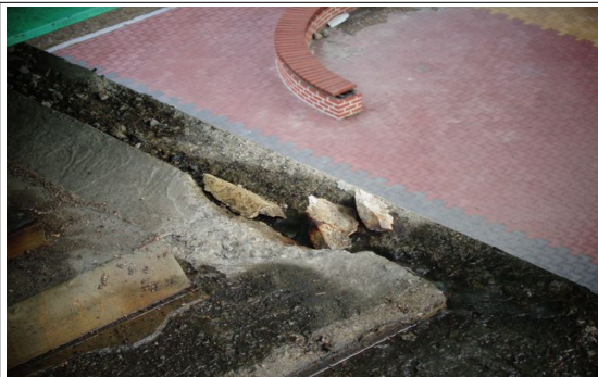
P11-SH1 받침 콘크리트 박락 (원주방향)
