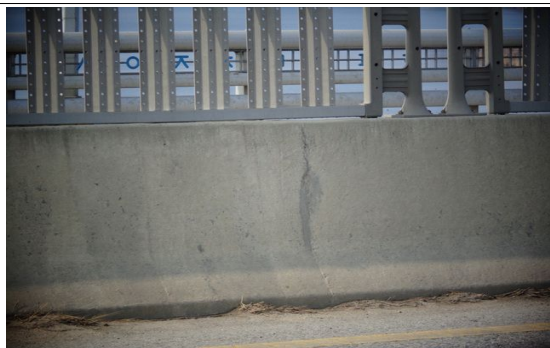
S24 중분대 균열 (양평방향)
