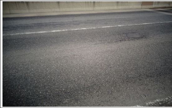
S5 아스콘 균열 (원주방향)
